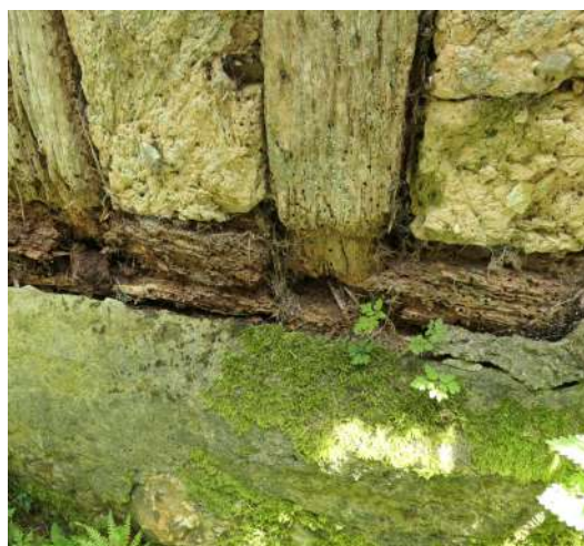
Pourrissement de pièces de bois au niveau du soubassement
