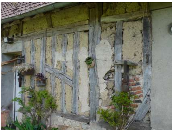
Matériaux composant le remplissage des pans de bois sont hétérogènes (modification de la perspiration du mur).
