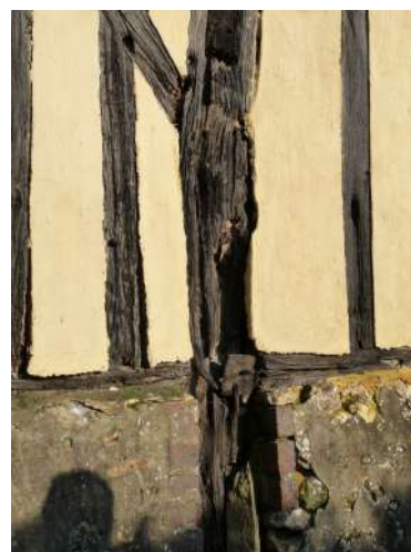
Pourrissement de la partie basse du poteau
