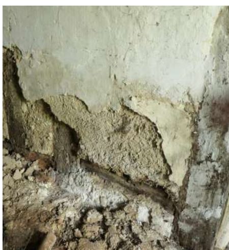
Pourrissement et moisissures provoqués par les remontées capillaires : soubassement (en maçonnerie) de hauteur insuffisante par rapport au plancher qui absorbe l'eau du sol et du sous-sol.
