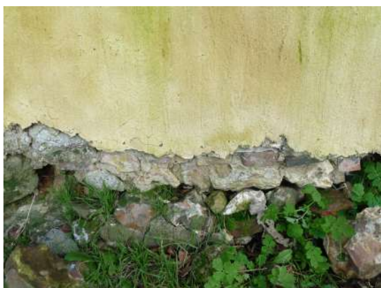
Soubassement dégradé par le rejaillissement de l'eau
