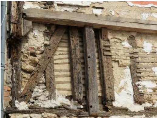
Pourrissement de pièces de bois et dégradation du torchis par infiltration d'eau qui n'a pu s'évacuer et stagne dans un interstice (entre deux murs) ne voyant pas le jour : pas d'aération suffisante.
